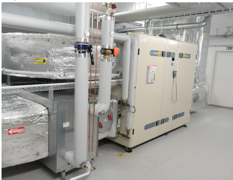
Figur 3 Ventilationsaggregatet i norra husdelen, LA2, med tilluftskanalen nere till vänster med värmebatteri närmast ventilationsaggregatet och sedan kylbatteriet. Kylbatteriet tillför kyla till ventilationsluften om det finns behov av att kyla bort överskottsvärme från kontoret. Södra husdelen har ett likadant ventilationsaggregat, LA1.
