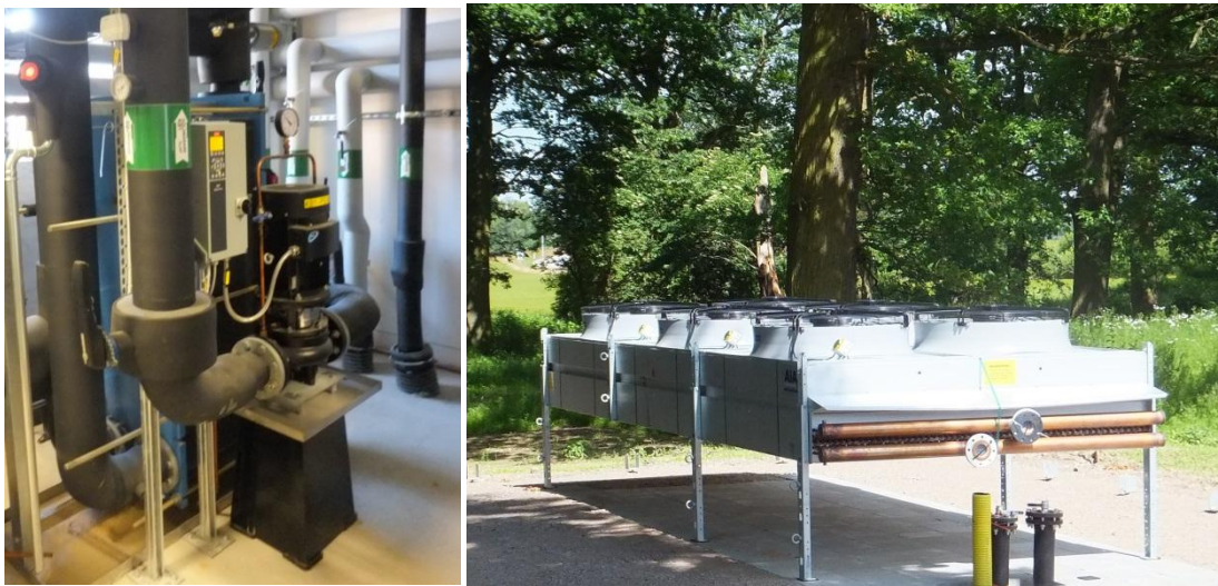
Figur 2 Bilden till vänster visar frikylapumpen som cirkulerar borrhålsvatten, som ska ge frikyla till alla fyra byggnader när området är fullt utbyggt. Man har även skapat en möjlighet att producera ännu mer kyla om frikylan inte skulle räcka en mycket varm sommardag, när området är fullt utbyggt. Den extra kyleffekten får man genom att köra värmepumparna, som då sänker temperaturen på borrhålssidan och den producerade värme avges i skogsdungen med hjälp av kylmedelskylare, bilden till höger.
