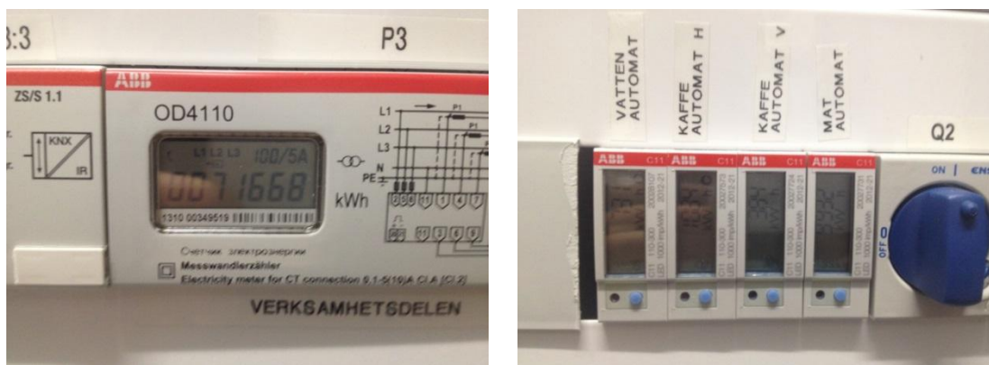
Figur 14 Elmätare verksamhetsel installerad 1 maj 2013 samt elmätare för matautomat etc. före industrisemestern 2013.
