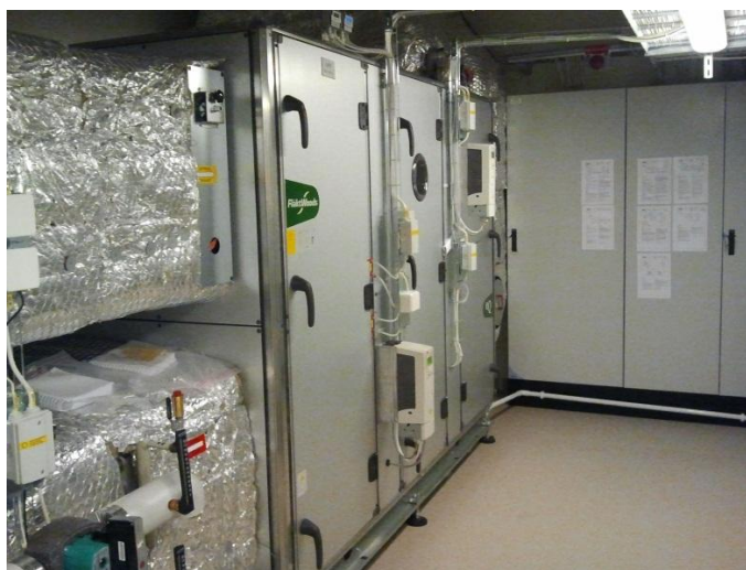
Bild 5 Ventilationsaggregat för allmänventilation avdelningar och personalutrymmen
