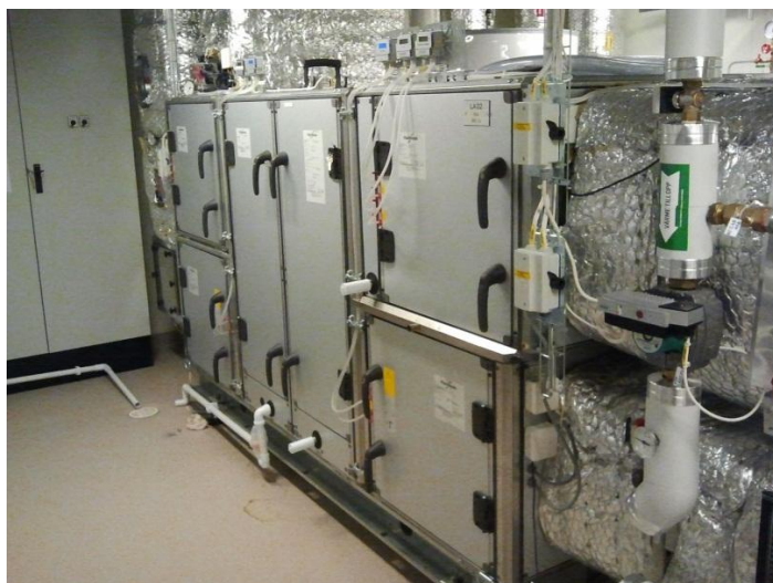
Bild 6 Ventilationsaggregat för kök och dess biutrymmen
