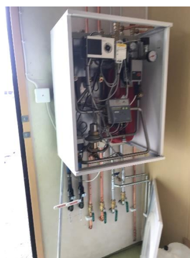
Figur 4 Fjärrvärmeväxlare i bod utvecklad av Aroseken och Mälarenergi. (Bild: Aroseken)
