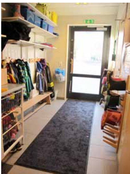
Groventré och vindfång saknas.
