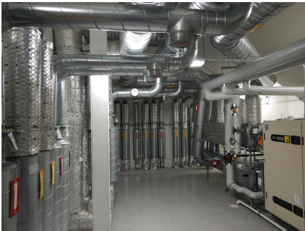
Figur 5 Fläktrum hos Vätterhem, där luftflödena enkelt justeras in till och från varje lägenhet samt mäts med litet fel. Detta underlättar och snabbar upp luftflödesmätningarna för injustering och kommande OVK, då det mesta finns tillgängligt i fläktrummet.
